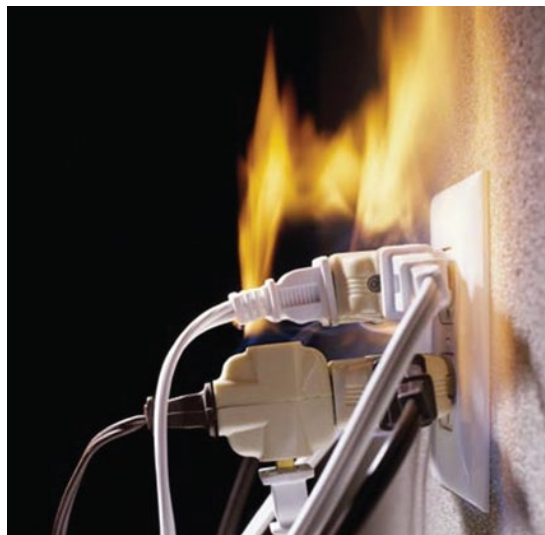
Início de incêndio por sobrecarga elétrica.
