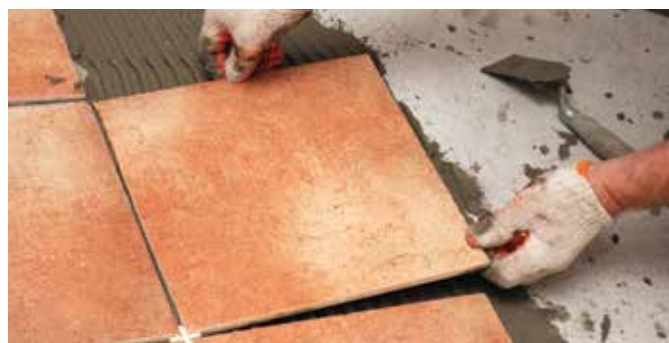
Klej do płytek nakładać na uprzednio zainstalowane płyty Promat przed nałożeniem na nie płytek.
