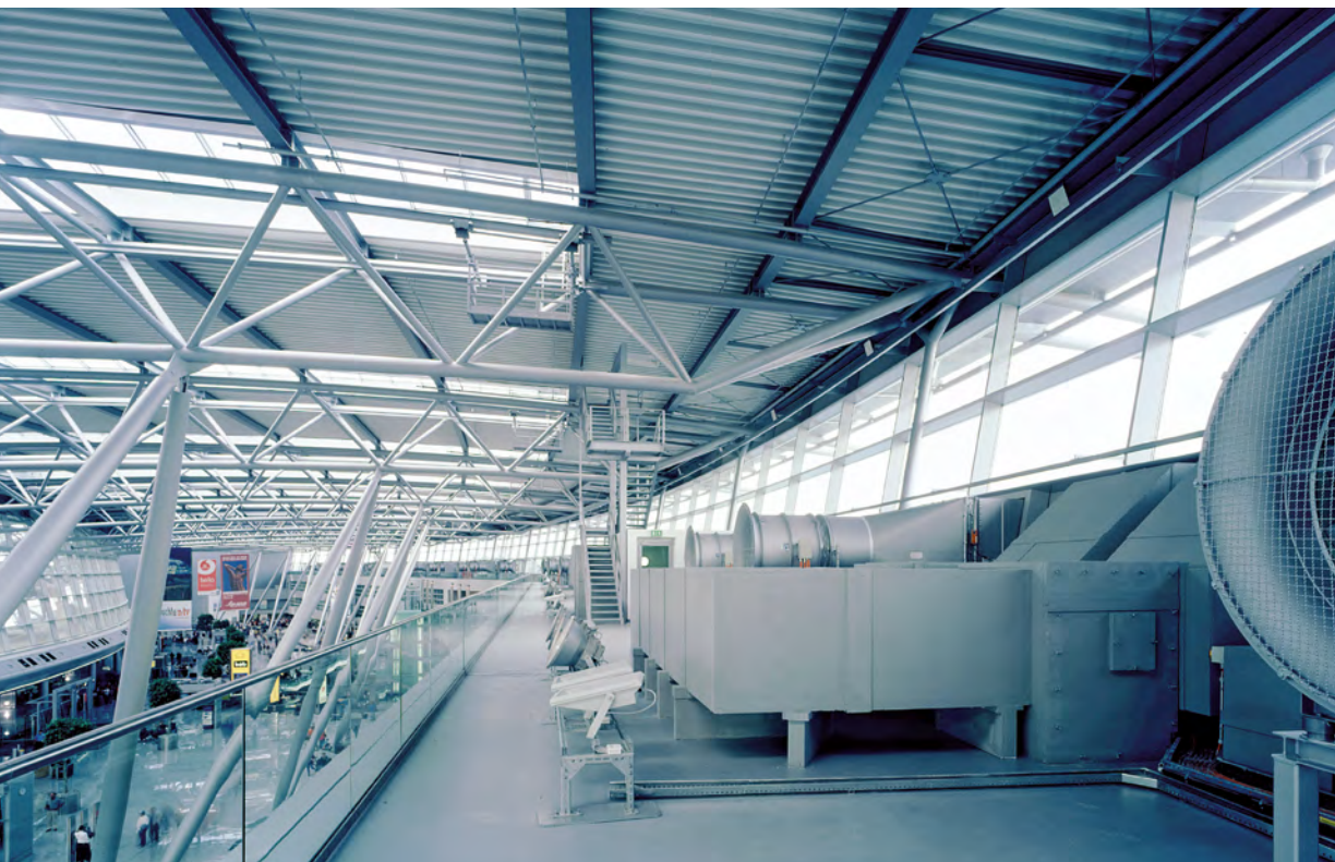
Entrauchungsanlage im Hauptgebäude am Flughafen Düsseldorf
