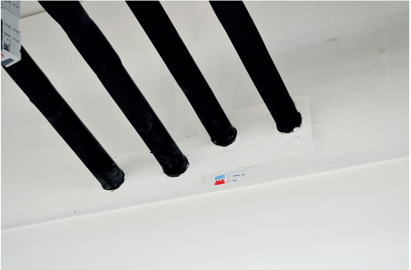
Prostupy potrubí s požárně ochranným pásem PROMASTOP®-W
