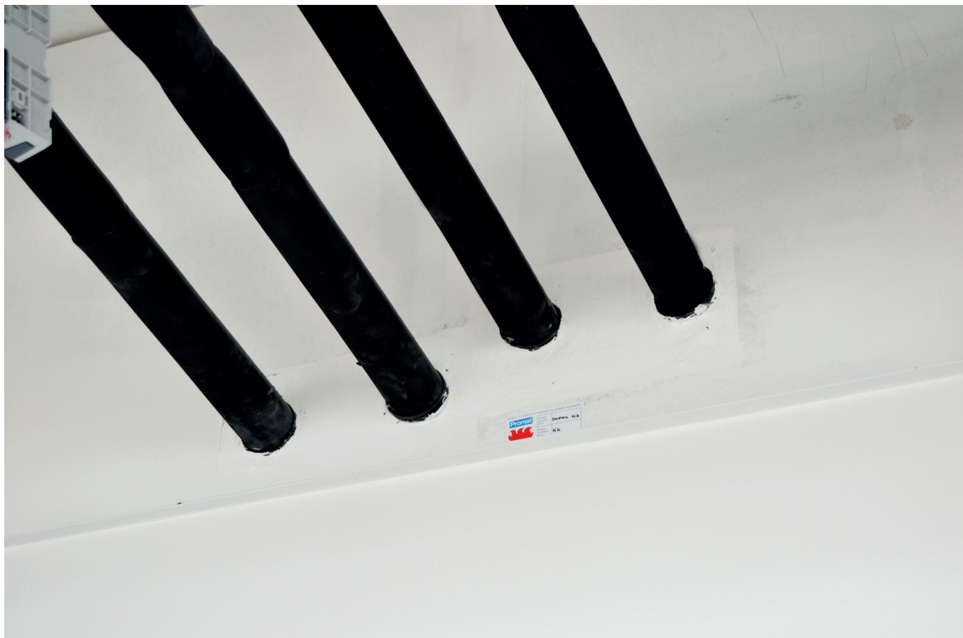
Prostupy potrubí s požárně ochranným pásem PROMASTOP®-W
