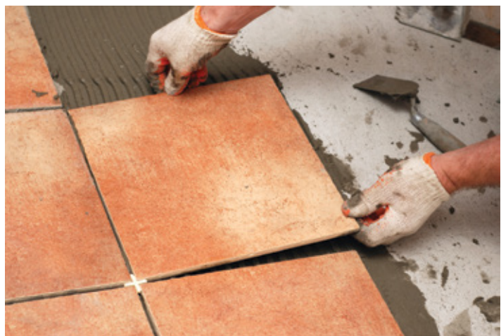
Nanošenja ljepila za pločice na prethodno ugrađene Promat ploče prije ugradnje pločica
