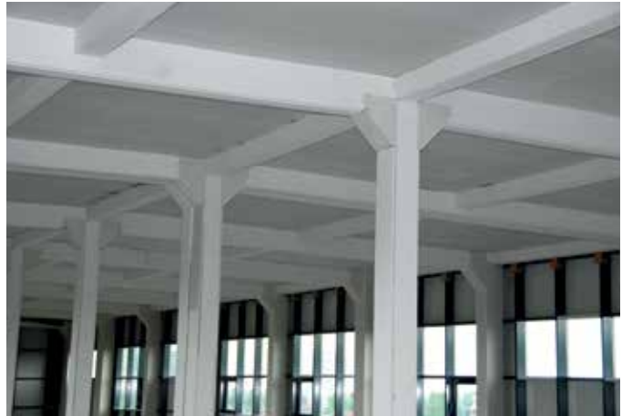
Stalen liggers en kolommen brandwerend beschermd met PROMATECT®-H
