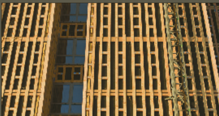
4 Opbouw houten draagstructuur inclusief isolatie voor nieuwe gevelbekleding. Construction de la structure portante en bois, y compris l'isolation pour le nouveau revêtement de façade.
